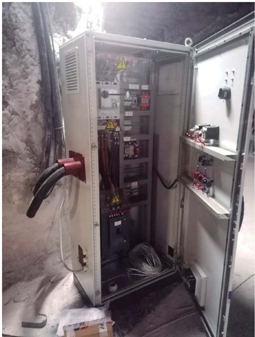
Armario eléctrico para el impactor Miningland.
